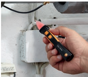
Бесконтактная проверка напряжения на распределительной коробке с testo 745.
