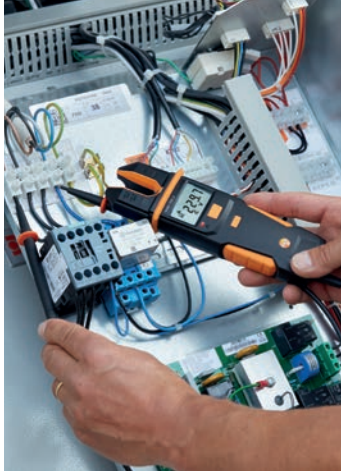
Измерение напряжения на компрессоре с testo 755.
