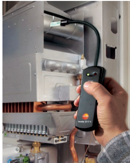
Рис. 17: Использование детектора утечек для контроля обратной тяги
