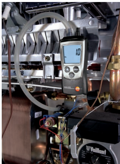
Рис. 9: Проверка давления в газовых магистралях с помощью testo 510 мощности через соответствующее меню управления и измеряется давление газа поступающее в топливосжигательную систему. Если давление допустимо, измерительный штуцер снова закрывается и продолжается процесс ввода в эксплуатацию.
